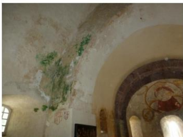
Chapelle - Nef. L'humidité et les taches de moisissures sont nettement visibles sur les parois et les peintures murales
