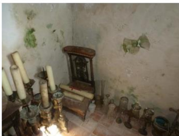
Chapelle - Humidité et moisissures dans la sacristie
